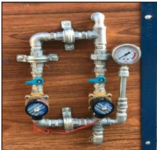
รูปที่ 4.23 ชุดระบบควบคุมแก๊ส
