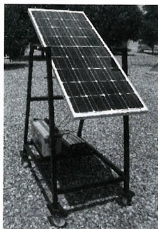
รูปที่ 3.9 ชุดระบบพลังงานไฟฟ้าจากโซลาร์เซลล์
