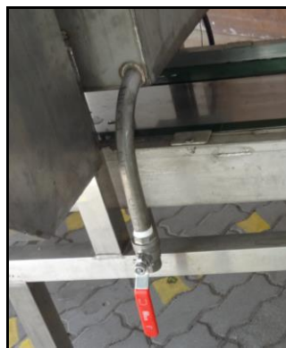
รูปที่ 3.22 ท่อระบายน้ำออก
