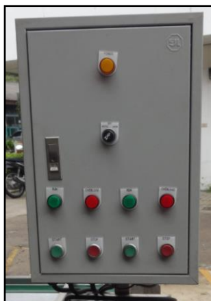
รูปที่ 3.14 แผงวงจรไฟควบคุมการทำงานชุดสายพานลำเลียงถาดพิมพ์
