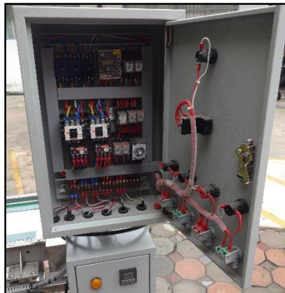
รูปที่ ข.4 ลักษณะของระบบไฟ
