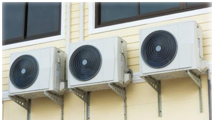
ภาพที่ 3.4 ระบบปรับอากาศ แหล่งที่มา: Daikin เว็บบ (2565)
