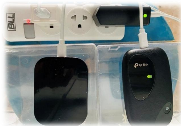
ภาพที่ 4.3 ติดตั้งระบบส่งข้อมูลพลังงานเรียลไทม์
